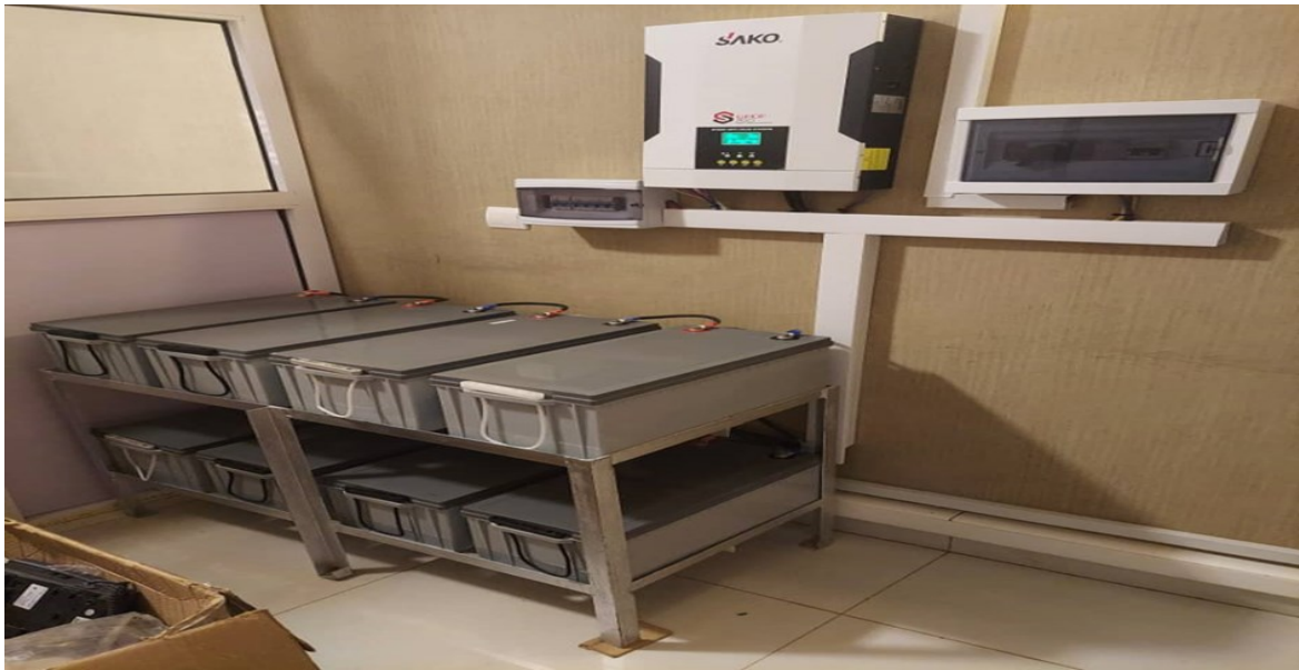
Les huit batteries
