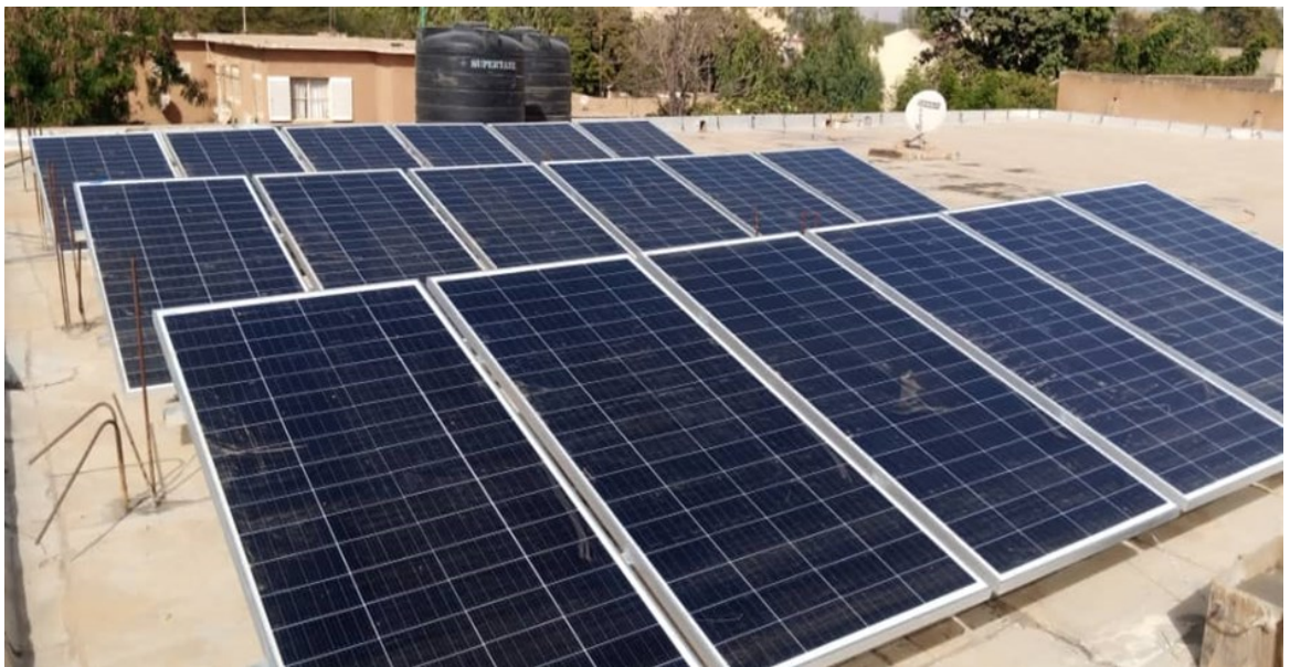
Les 18 panneaux solaires sur le toit du bureau
