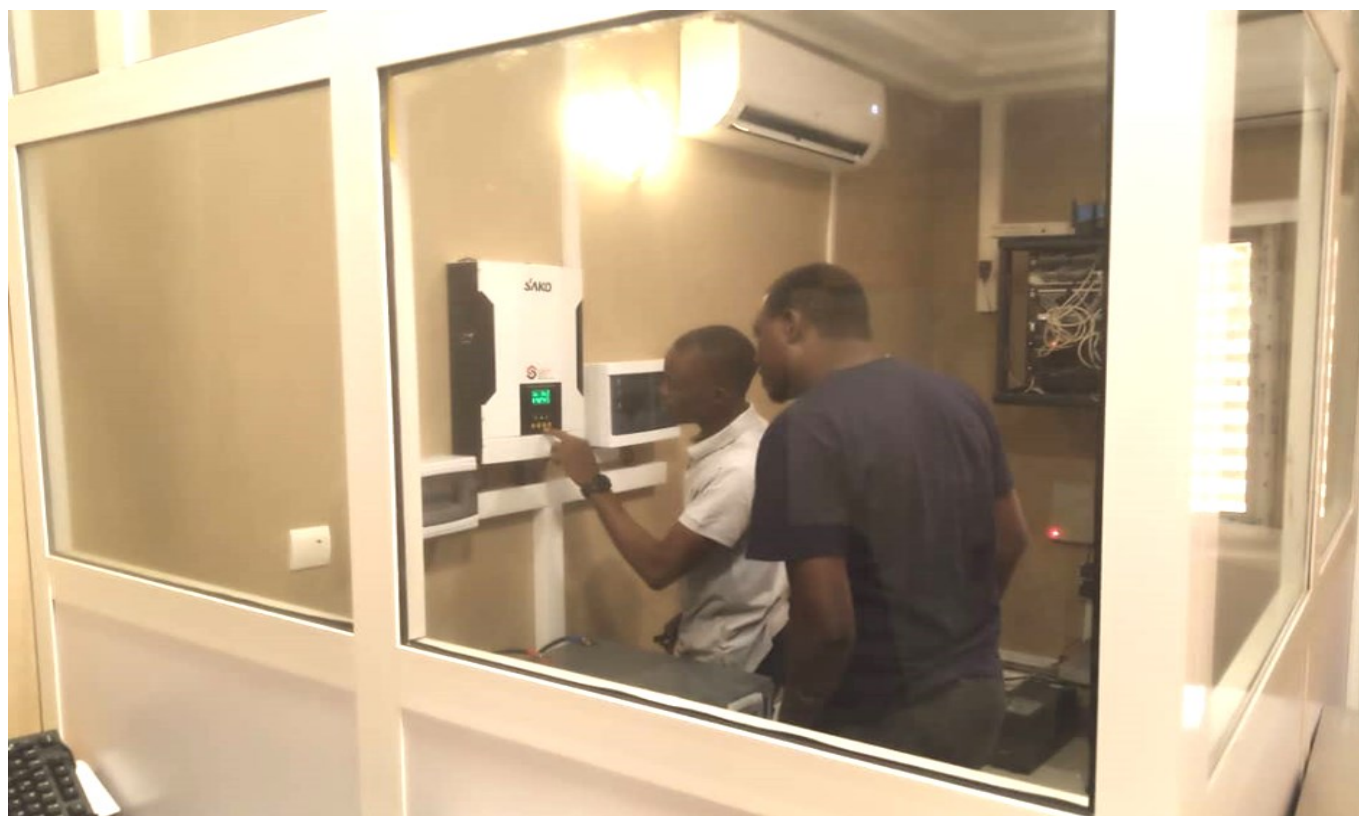
Le IT du bureau (en noir) vérifiant les installations dans la salle informatique
